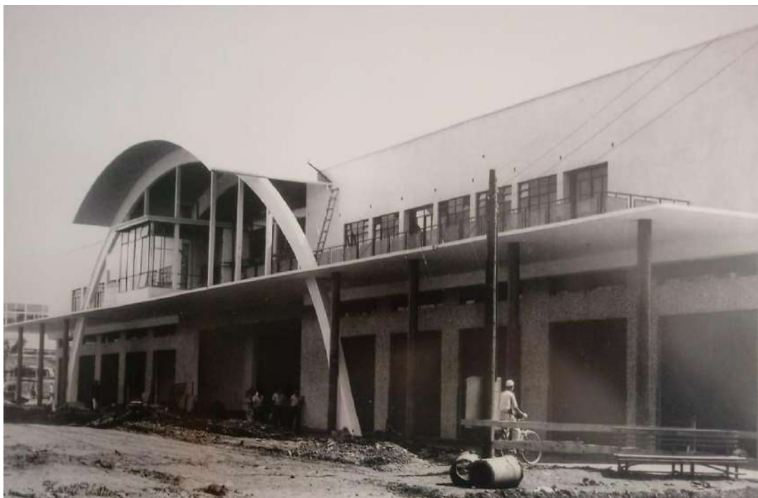
Figura 10: A Terceira Estação Rodoviária de Maringá em obras, década de 1960 Fonte: Keiji Ueta/ Acervo da Gerência de Patrimônio Histórico de Maringá
