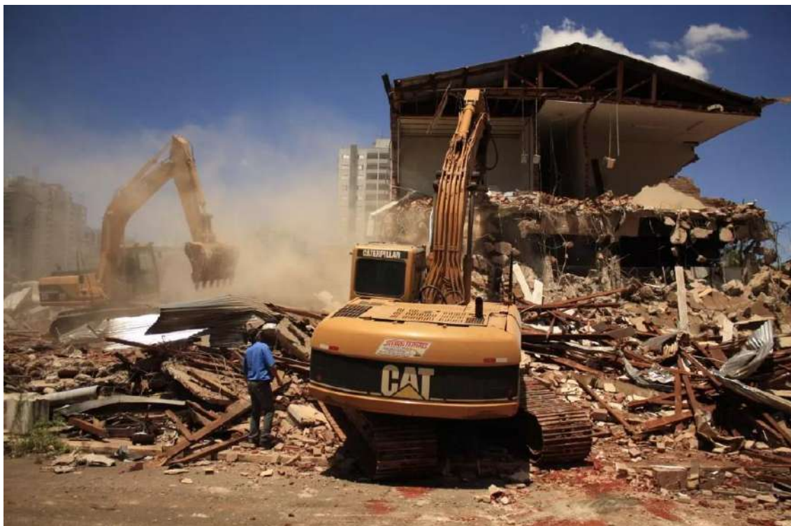
Figura 23: A demolição da Estação Rodoviária Américo Dias Ferraz, novembro de 2010 Fonte: Cauê Sanchez / Maringá Post
